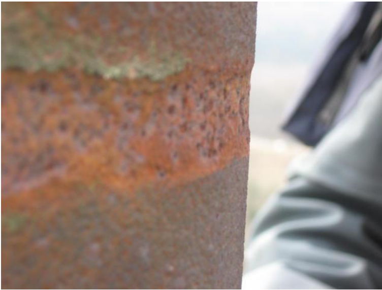
Bild III/6.3.1.4-1 Materialverlust durch Korrosion im Bereich einer Bandschelle
