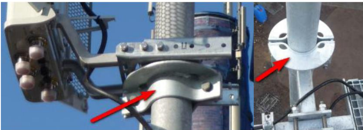
Bild II/3.3.2-1 DFMG: Drehteller unterhalb einer aktiven Antenne
