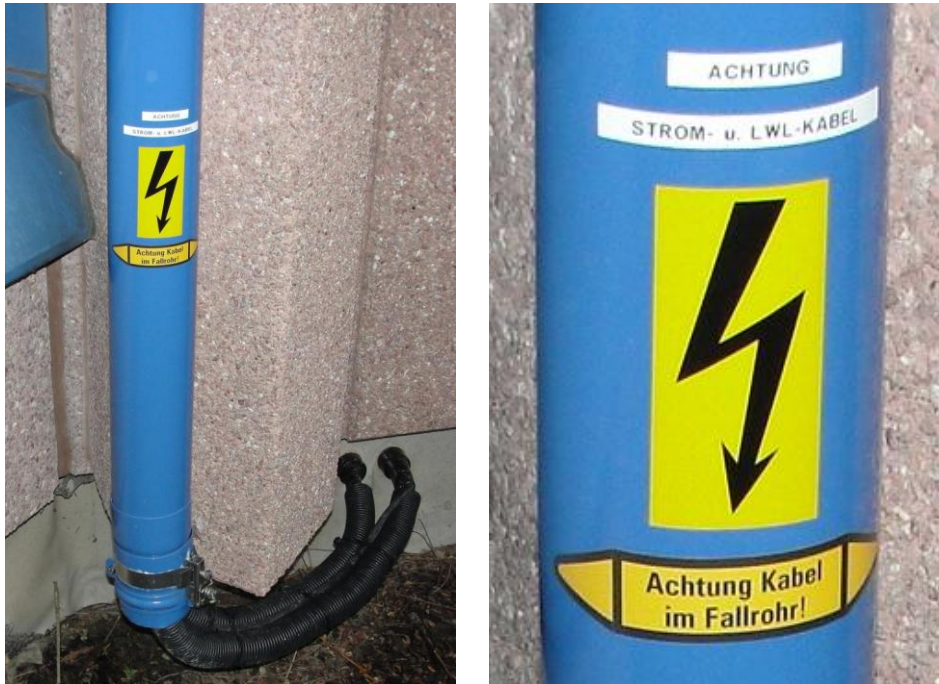
Bild I/11.3.5-1 DFMG Beispiel „Kabel im Fallrohr“
