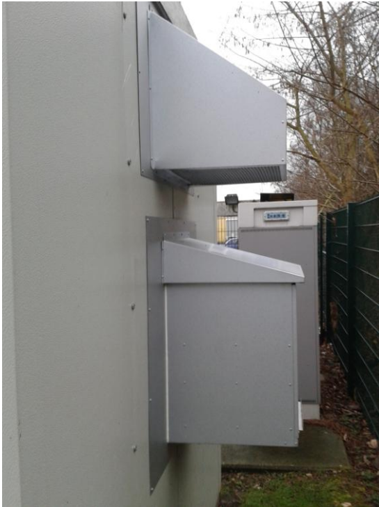
Bild I/17.2.1.4-2 DFMG: Dantherm Flexibox an Stelle defektes York YT Gerät
